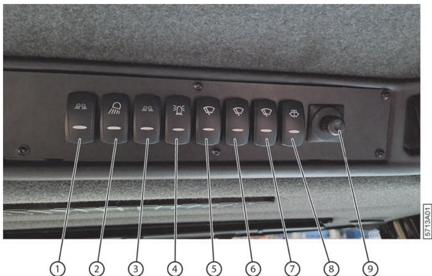
Fig. 17: Boutons de commande sur le toit de la cabine
